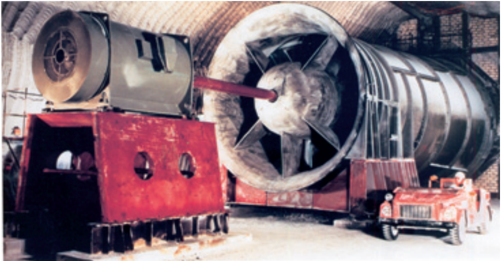
Hauptgrubenlüfter auf der 500 m-Sohle beim Schacht Weser
