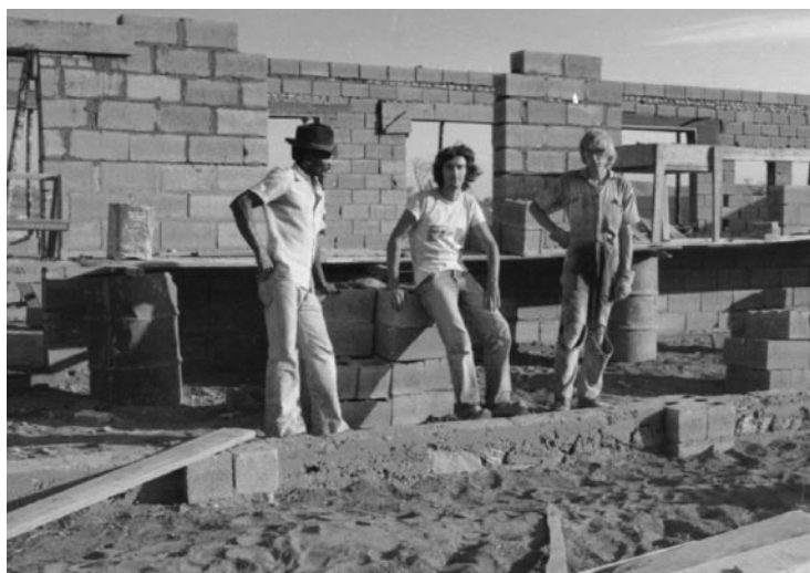
Baustelle in „Bona Espero“ (Esperanto: Gute Hoffnung), Alto Paraiso, Brasilien um 1980. Esperantisten als freiwillige Helfer beim Bau eines Schulgebäudes
