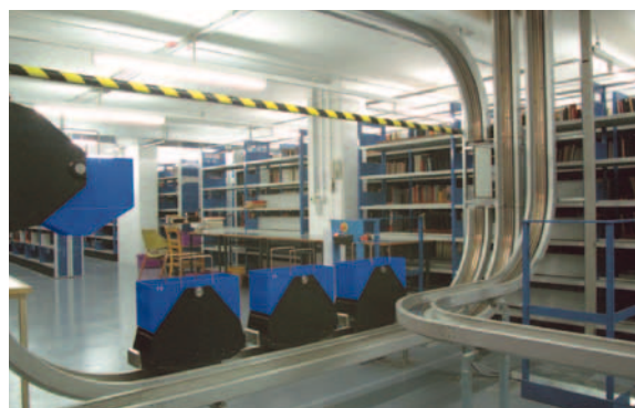
Station der neuen Teleliftanlage
